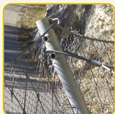
Poteaux des filets anti-éboulement 2
